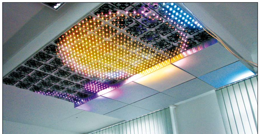
Bild 2: Professionelle LED-Beleuchtungslösungen von Comled Project, gefertigt von Rowatronic, zu begutachten im Democenter in Bochum
